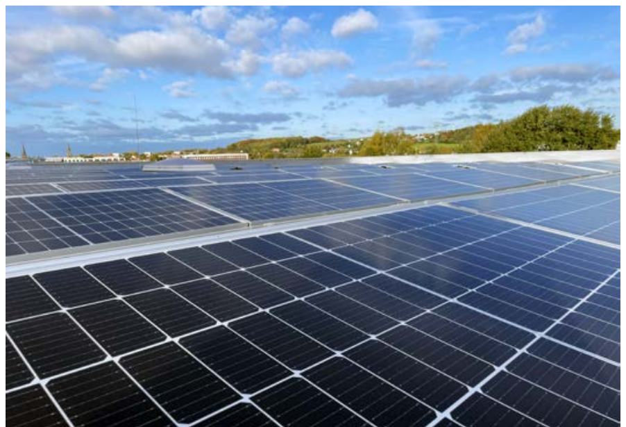
ARDEX-Photovoltaikanlage in Witten, Deutschland
